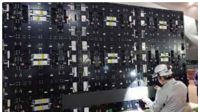
LED裏側制御盤
