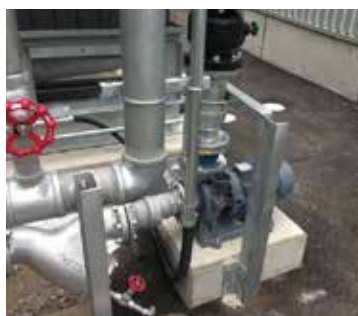
冷却水循環ポンプ
