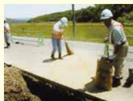
舗装に漏れた作動油に現場で備蓄していたオイルゲーターを撒き、油吸着させている状況。
