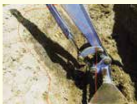
バックホーの作動油のホースが破裂して、内法面上に漏れた状況。
