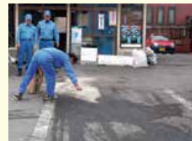
舗装面へこぼれた油の除去
