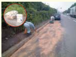
飛散したオイルにオイルゲーターを散布し、オイルを吸着させている状況。
